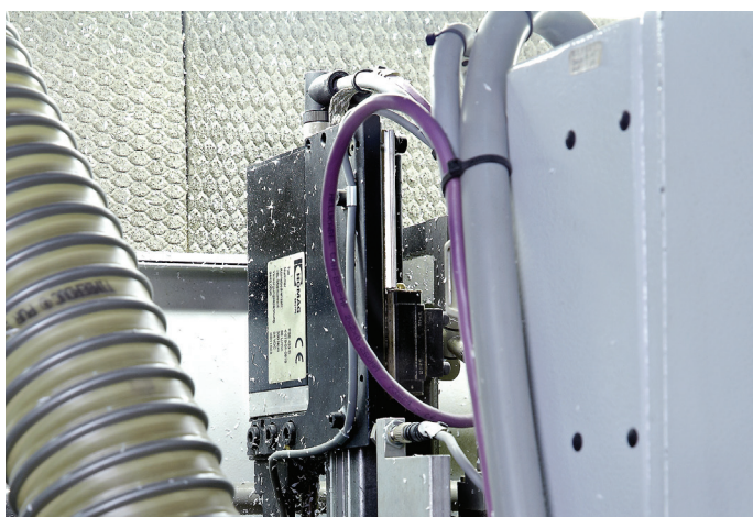
Abb. 5: Mit Hilfe der Positioniersysteme PSE von halstrup-walcher wird die Formatumrüstung zuverlässig durchgeführt – seit über 10 Jahren
